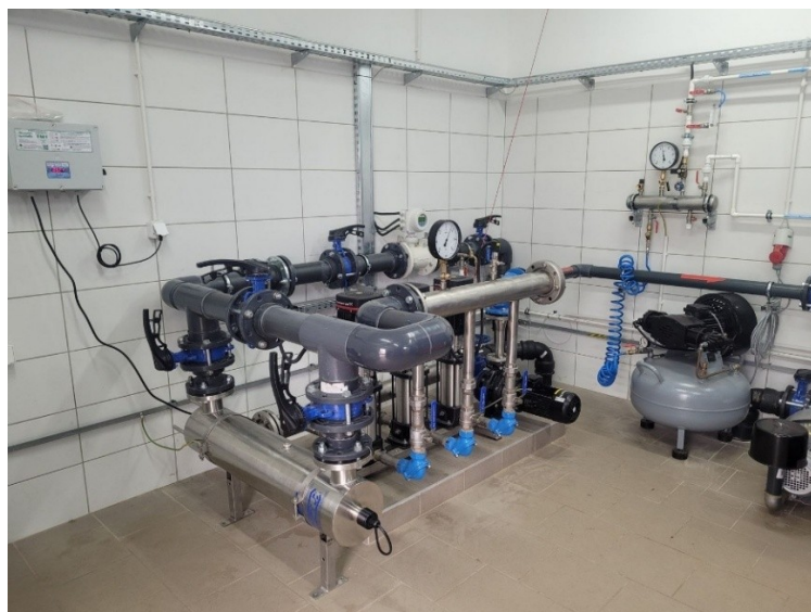
Zdjęcie nr 2: stacja uzdatniania wody w Broczynie
