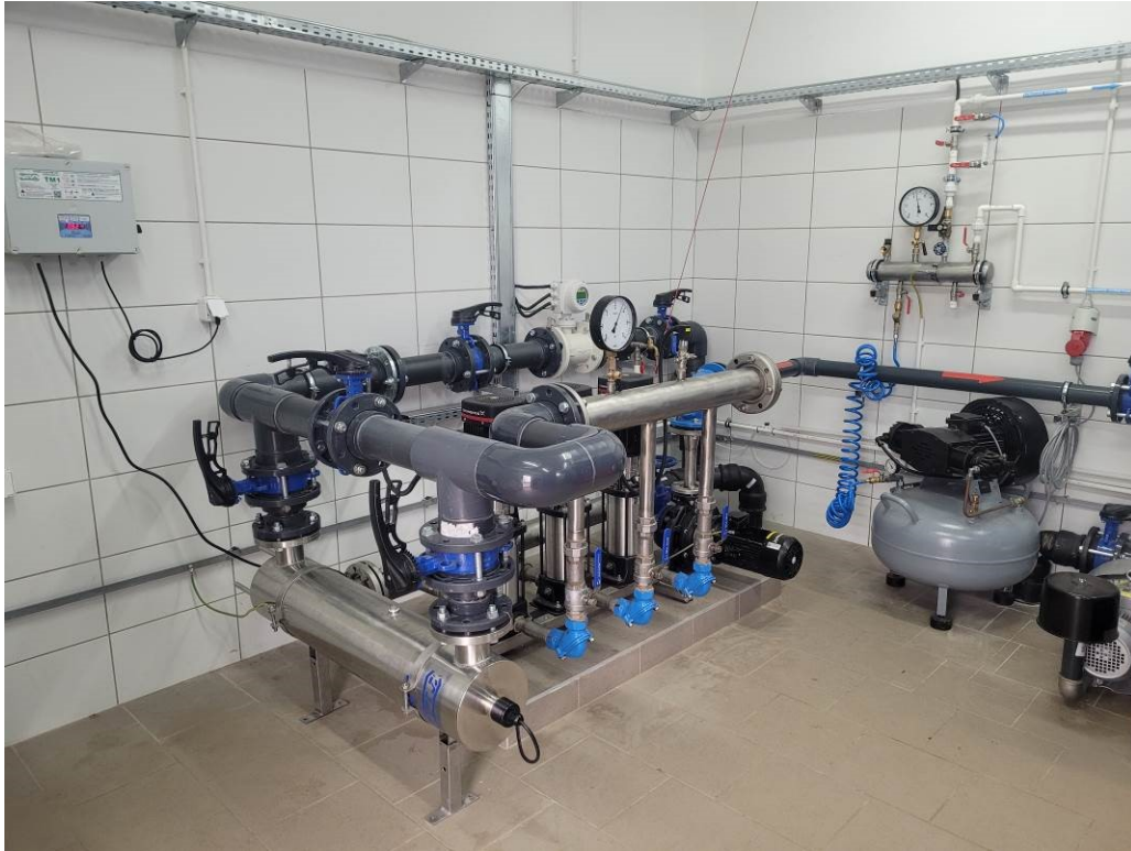
Wnętrze stacji uzdatniania wody w Broczynie
