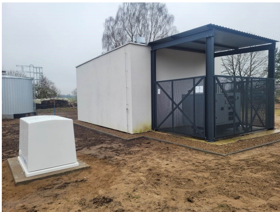
Ujęcie wodociągowe i stacja uzdatniania wody w Broczynie
